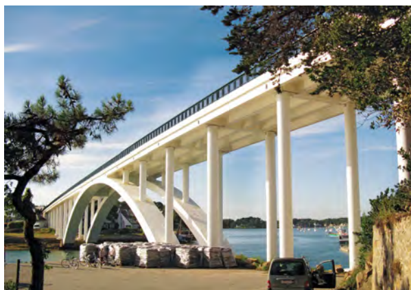
PONTE KERISPER, La Trinité-Sur-Mer, FRANCIA Progetto esecutivo per il risanamento delle colonne ammalorate.
